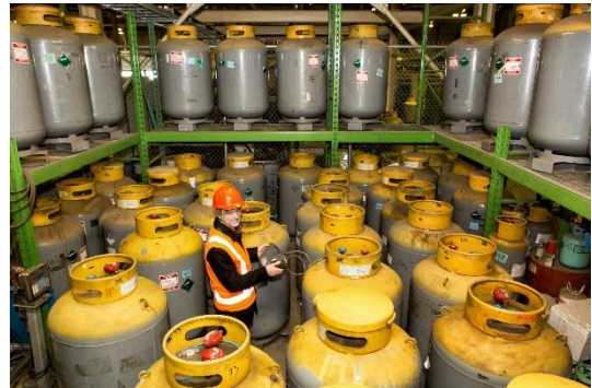
Figure-17: Cylindres de récupération de CFC 11
